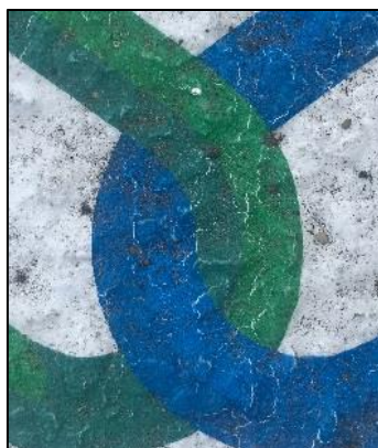
写真・下地の流動性に伴うフィルムのひび割れ外観
