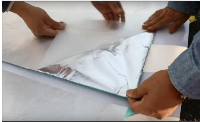
写真. バッキングテープの剥離
