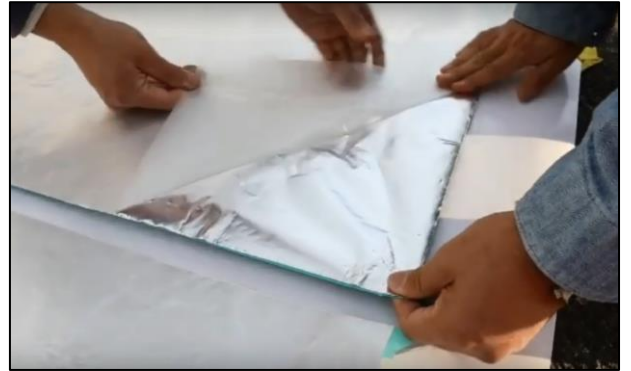
写真 3 バックリングテープの剥離
